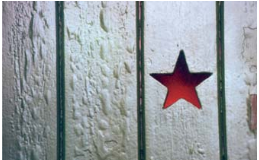
die aufheizung führt dazu, dass sich die alte, fette klarlacklackierung aufspaltet und sich vom untergrund ablöst.
